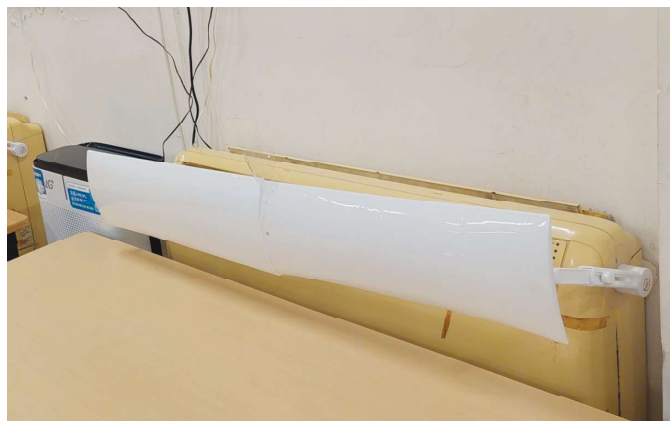
冷氣機擋風板
